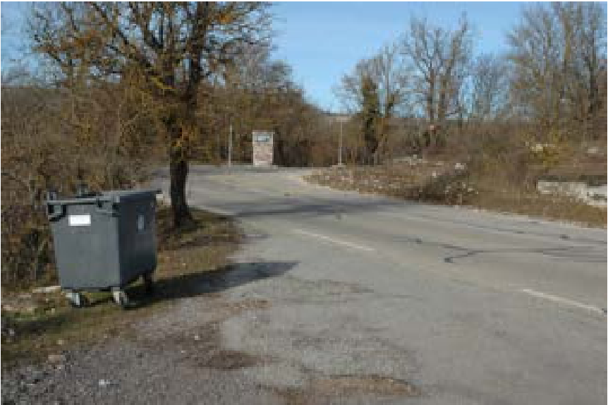
Entrées des parkings du Col de Vence : abords de voie dégradés
